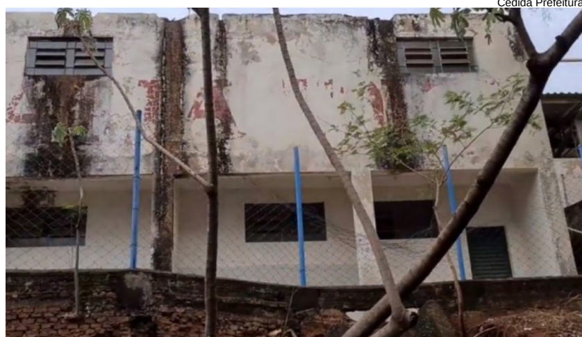
Estrutura antiga bem danificada
