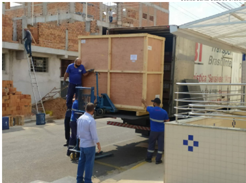
O ambiente onde ficará o tomógrafo se encontrava em preparo e aguardando os técnicos da empresa fornecedora para instalação
