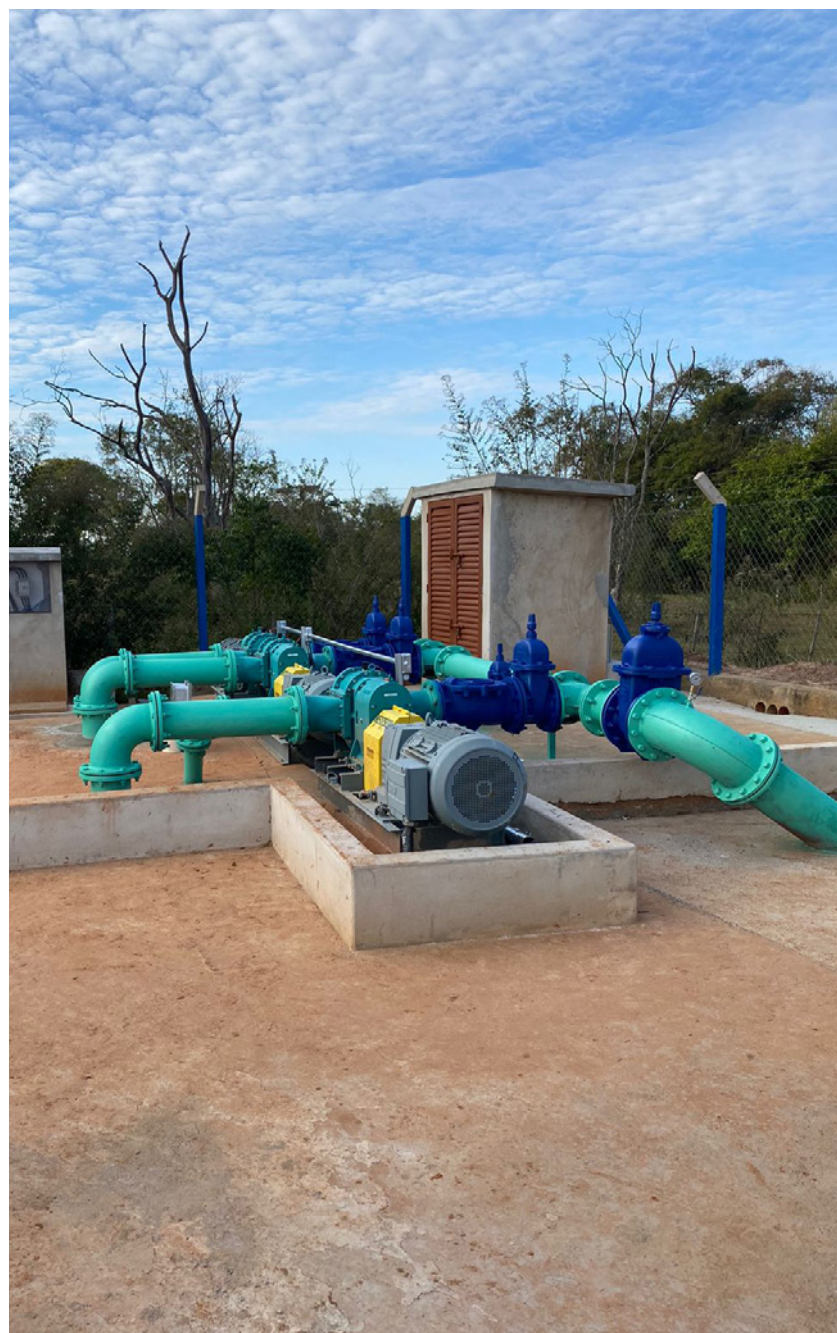
Elevatória no Residencial São Paulo
