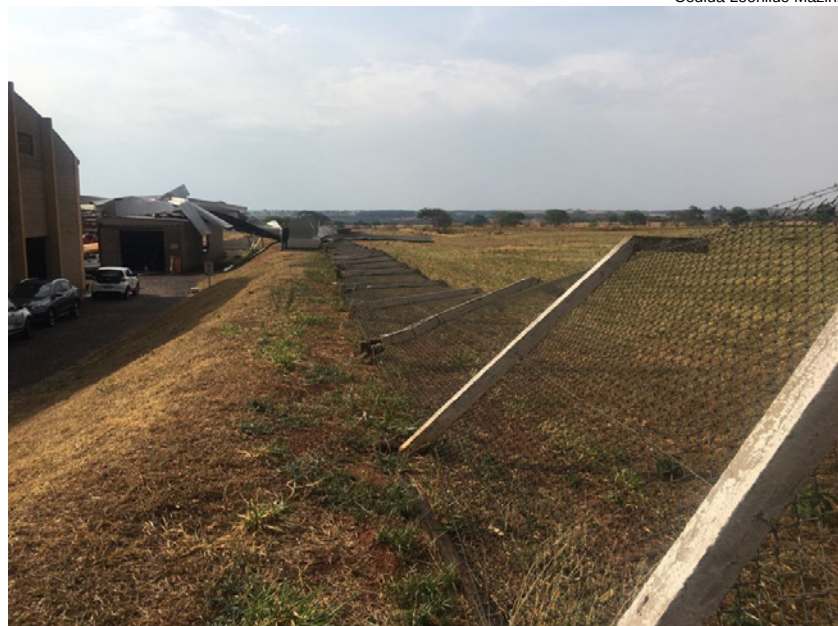
Alambrado foi destruído
