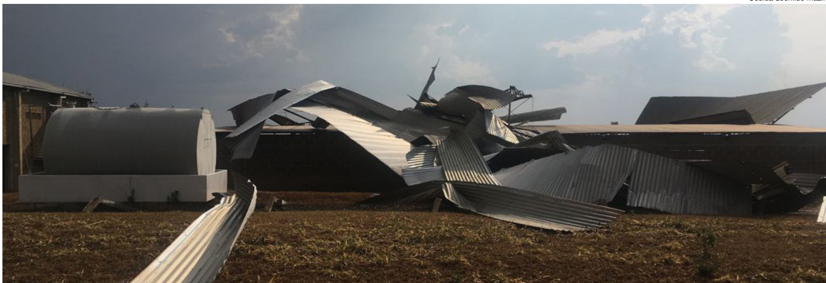
Estragos causados pela rajada de vento no aeroporto
