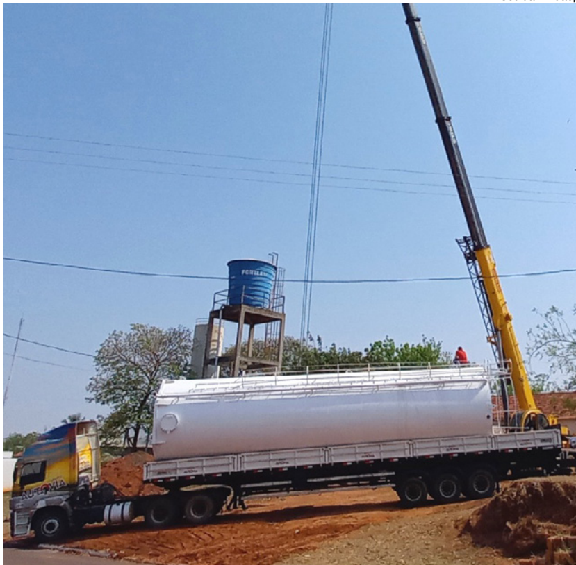
Bairro landara recebeu o reservatório de 80 mil litros
