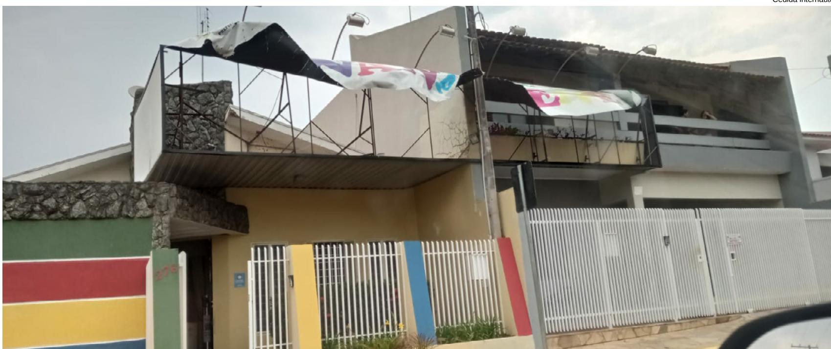
Fachada da Emei ficou danificada
