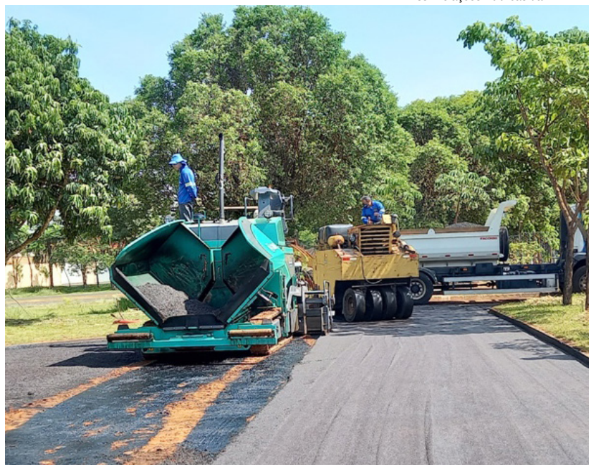
Pavimentação do acesso e do estacionamento na frente da EMEI Cantiga de Ninar, no Bairro Emílio Zanata
