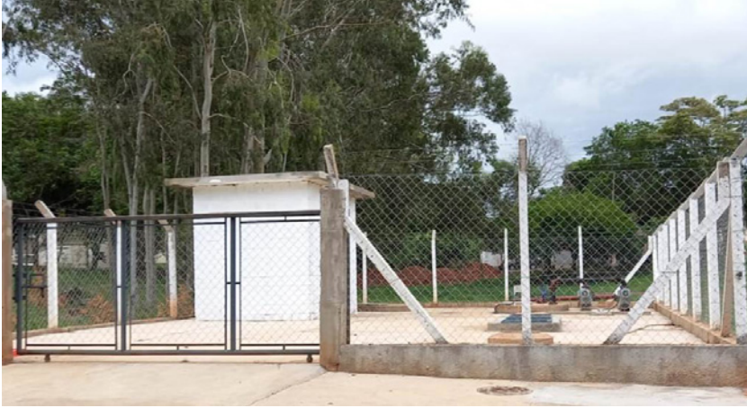
A equipe da EMDAEP colocou em funcionamento uma estação elevatória de esgoto na Rua Aristides Zanoni
