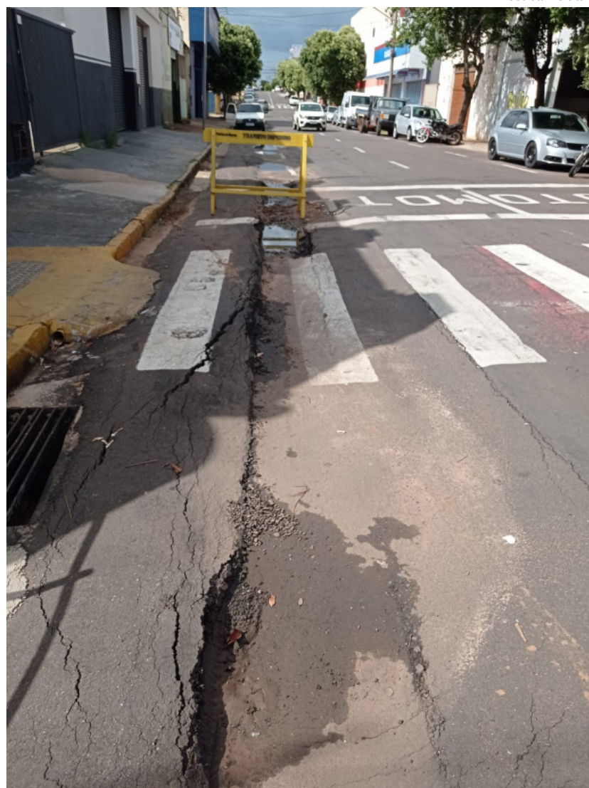
Quem passa pelo local nota que parte do asfalto está danificado e sinalizado com placas
