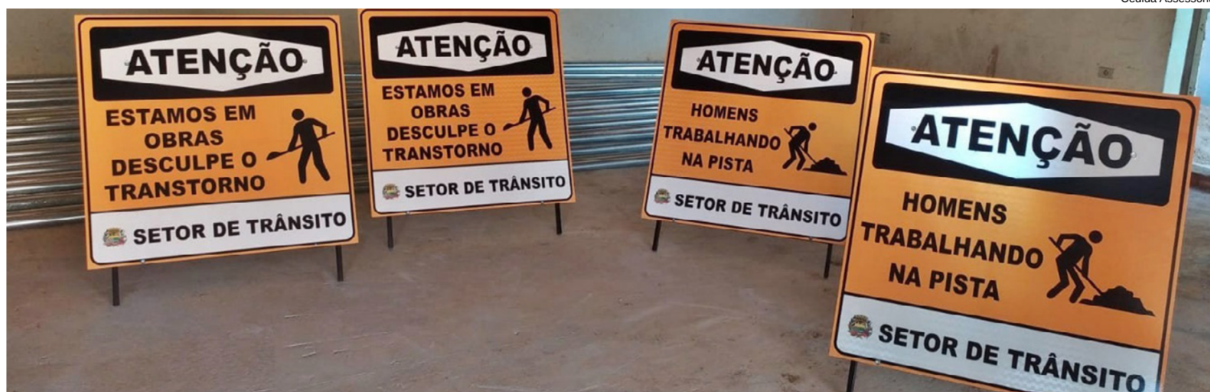
Placas de orientações a pedestres e motoristas
