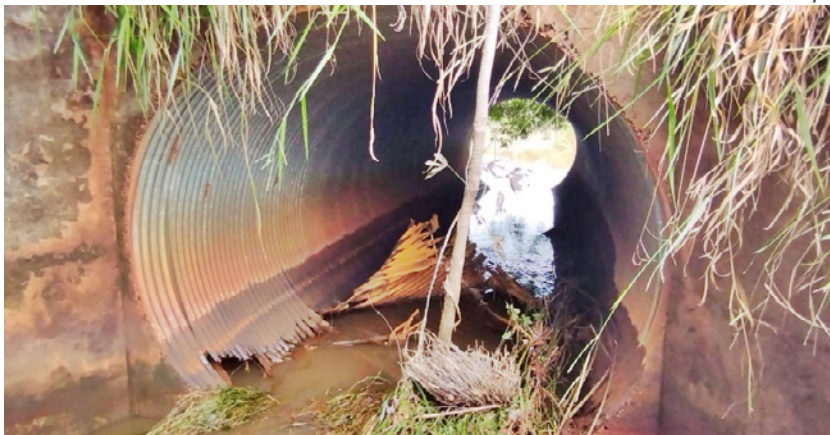
Tunel que passa sob a estrada danificado levou à interdição
