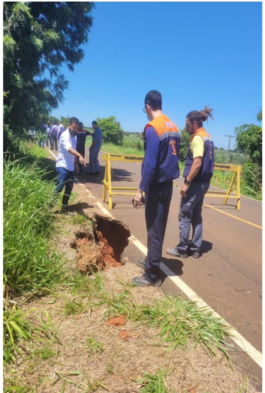
Buraco causado pelas chuvas no ponto interditado
