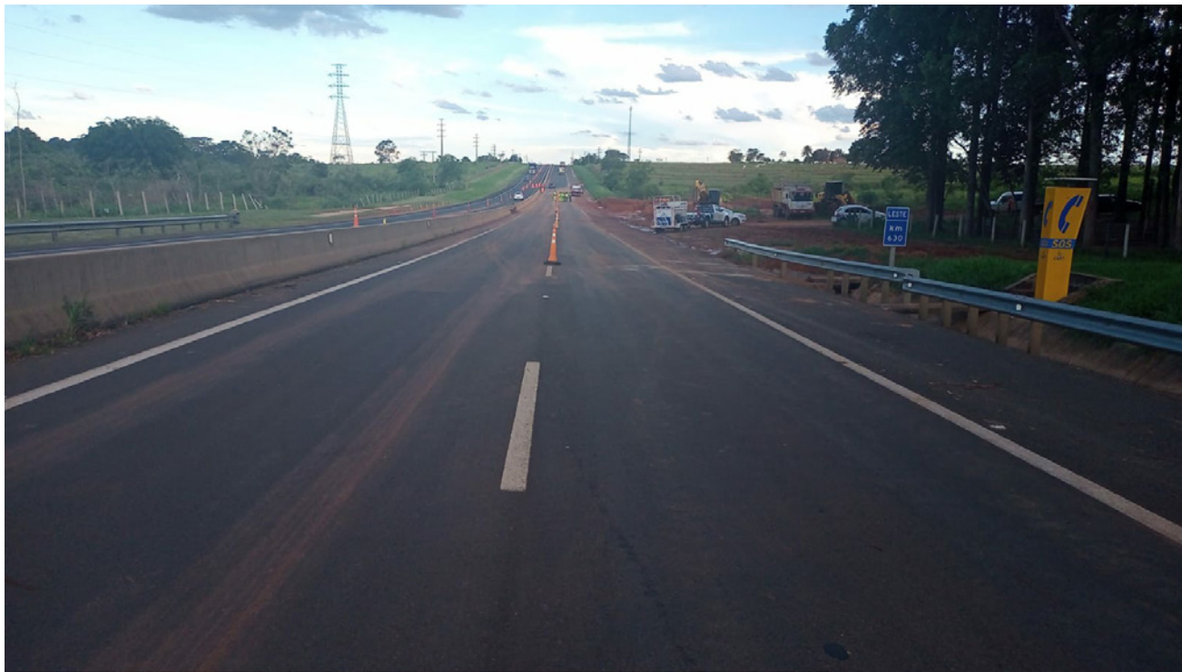
Pista da SP-270 liberada no município de Caiuá após fortes chuvas
