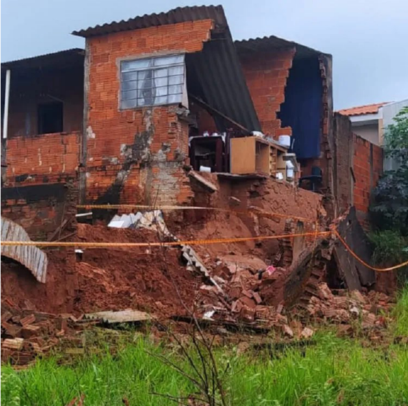
Parte da casa desabou com as fortes chuvas de quarta-feira, 4/1
