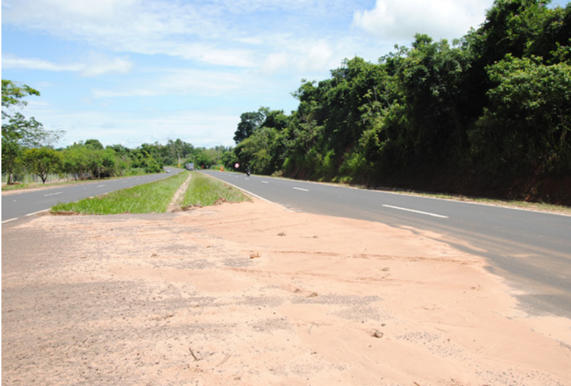
Trecho da SP-294 na divisa Dracena - Junqueirópolis um dos pontos de atenção
