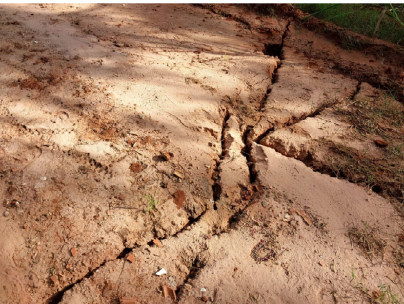
Cabeceira da ponte está comprometida
