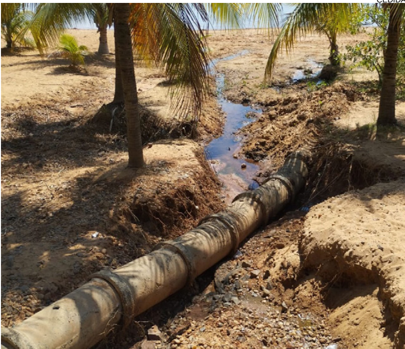
Tubulação será trocada
