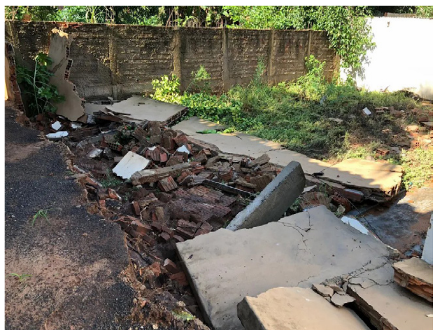
Quedas de muros também foram registradas
