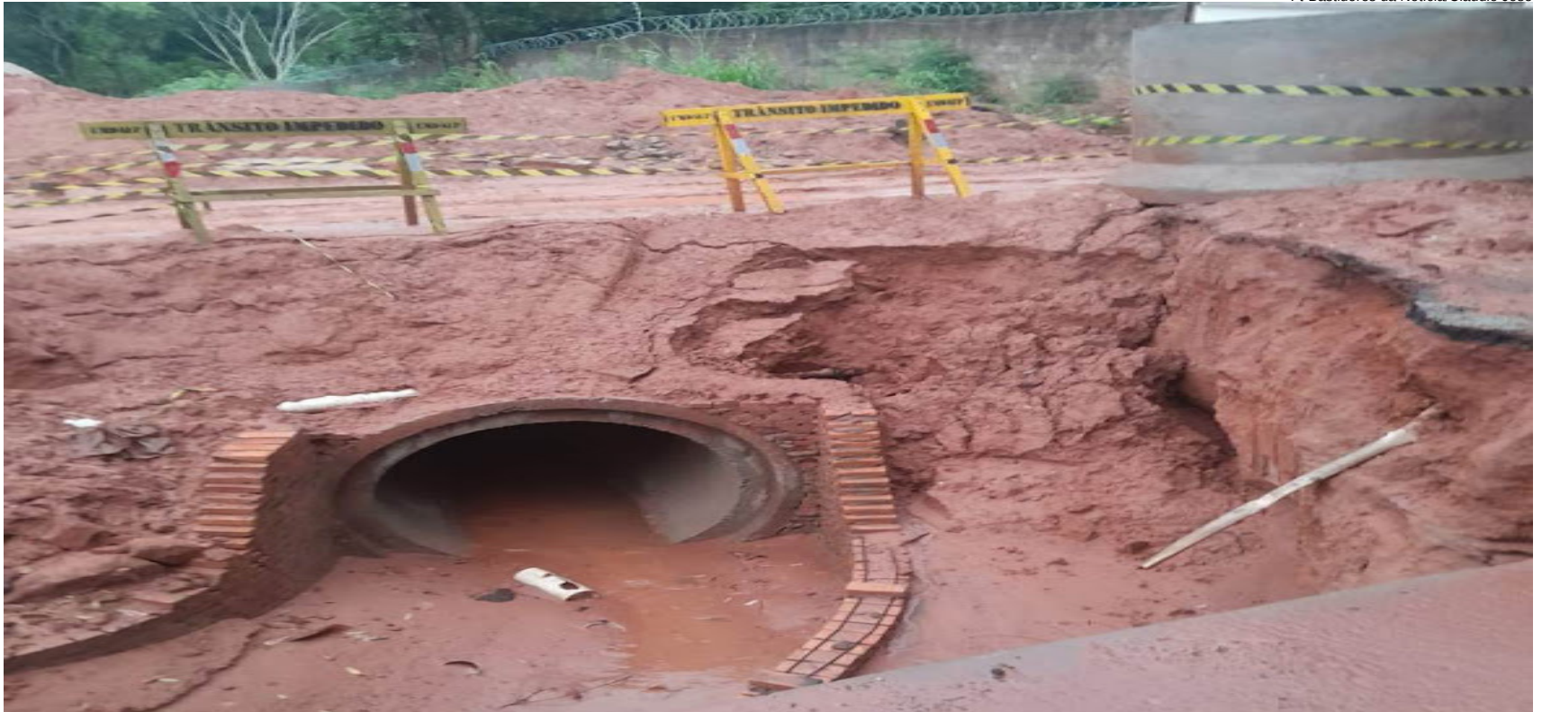
Trecho da rua Ipiranga em obras para ampliar rede de captação de águas pluviais
