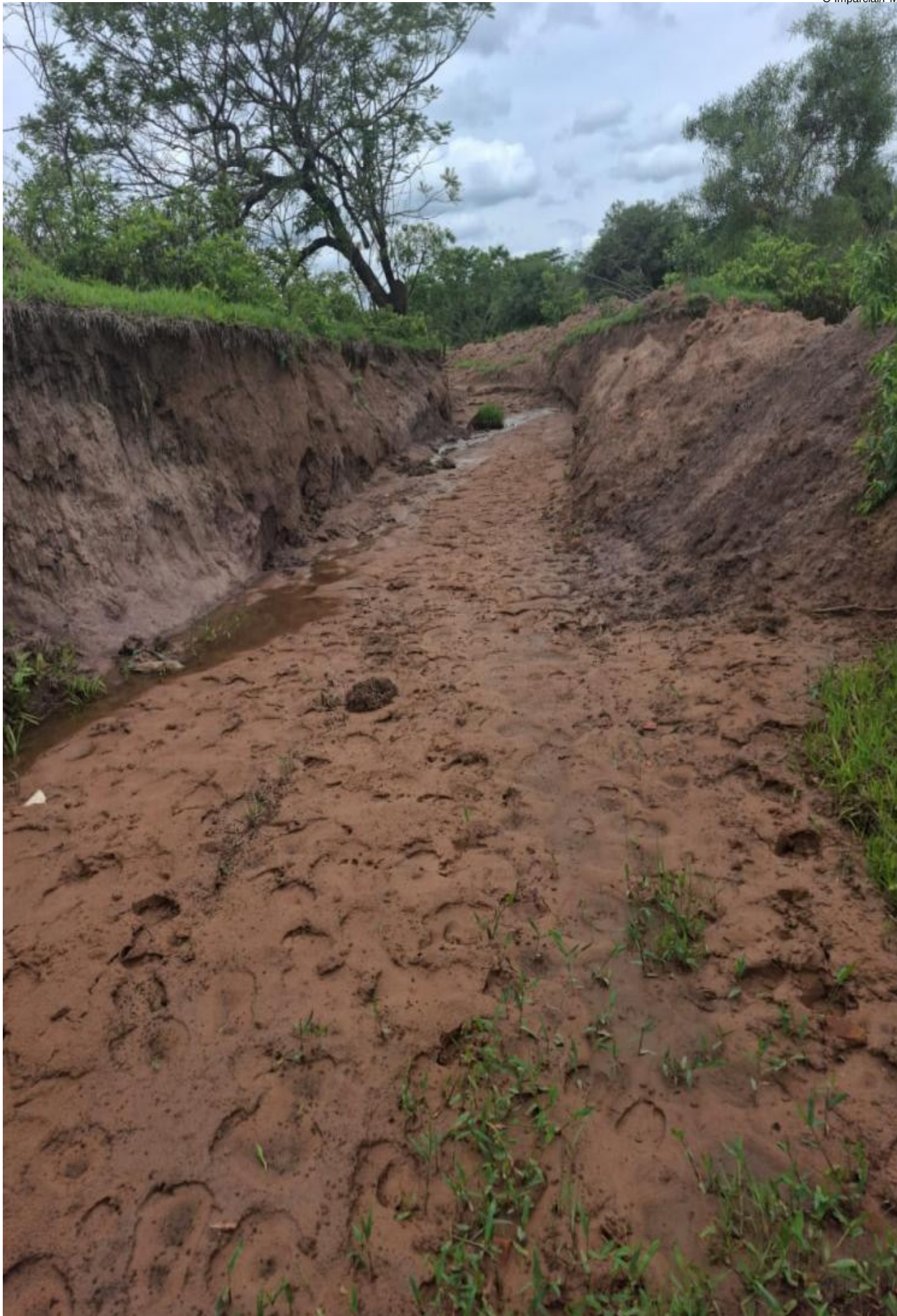
Degradação foi constatada em área de preservação permanente (APP)
