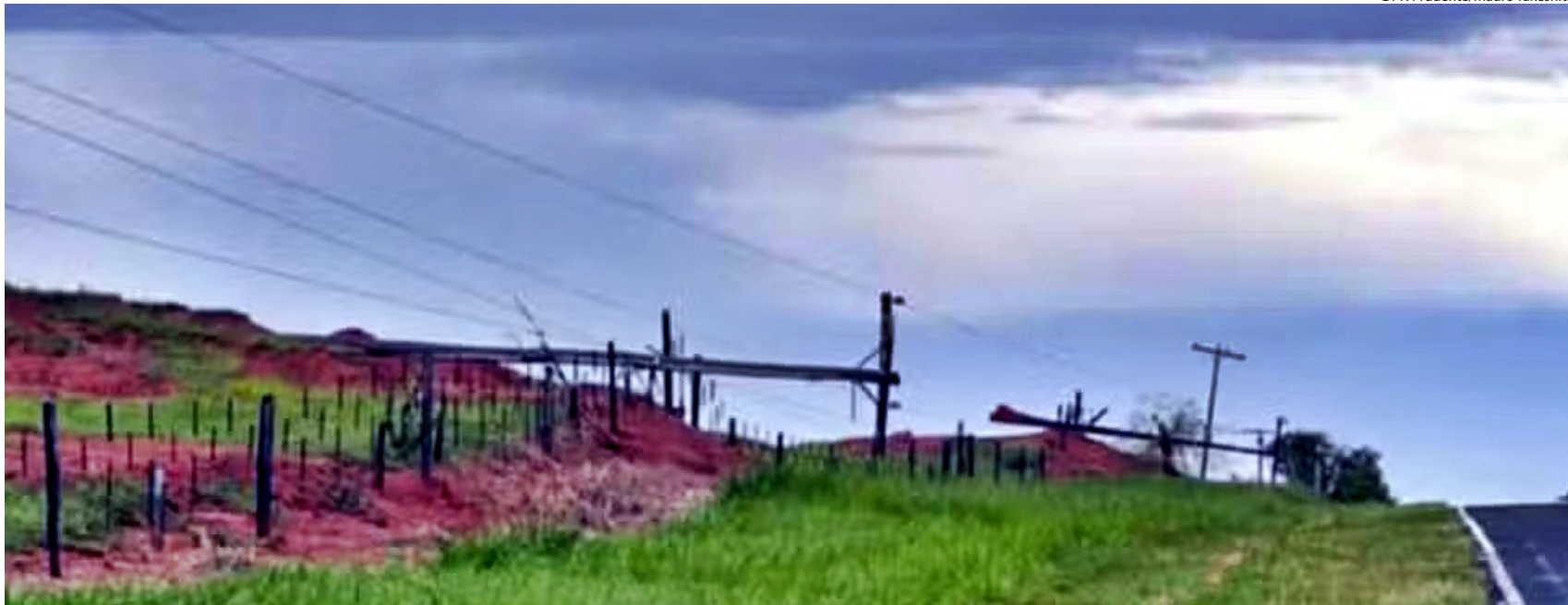
Dois postes de energia caíram na zona rural do distrito
